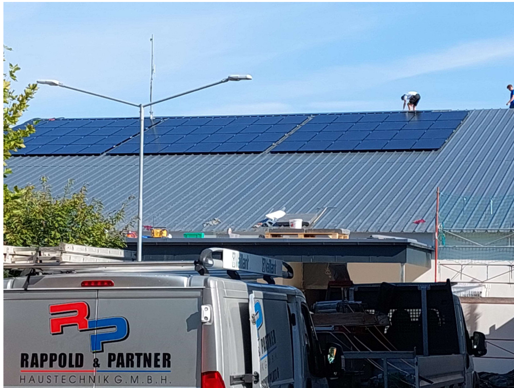
Photovoltaik-Anlage (PVA) - Dach Veranstaltungshalle (23,56 kWp)
