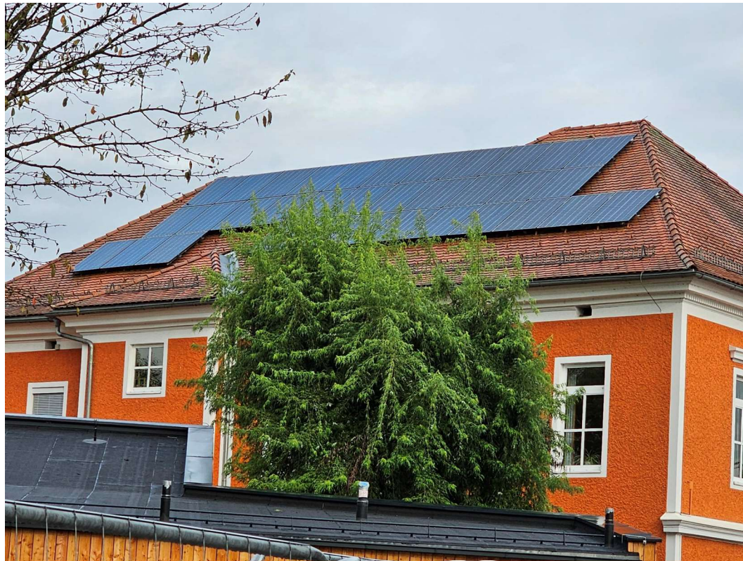
PVA - Dach Kindergarten Süd-Ost
