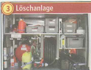
3 Löschanlage Im Wagen befindet sich eine Kleinlöschanlage (200 l Wasser), die mit Druckluft betrieben wird.
